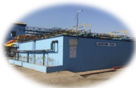
環境に配慮した排水、廃液設備
